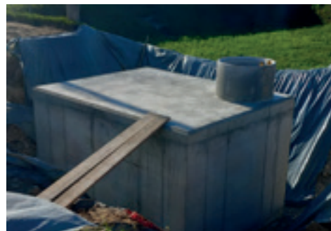
Verbundschacht Wasserversorgung (Symbolbild)
